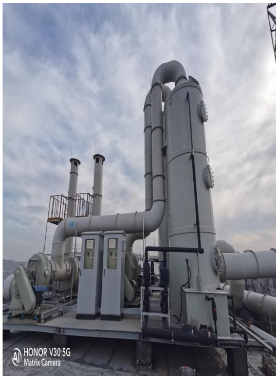
磷化铜抛洗工序废气处理设施及排气筒 (FQ-07)
