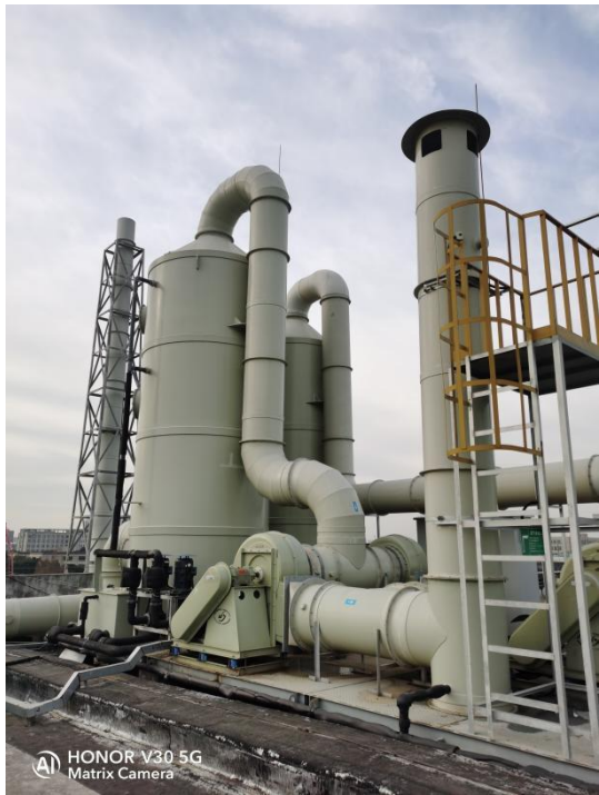
磷化铜酸洗工序废气处理设施及排气筒 (FQ-06)
